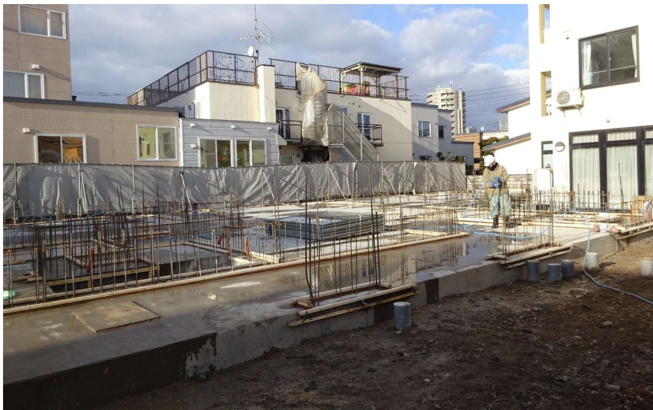
洗浄前の 1 階部分です。
