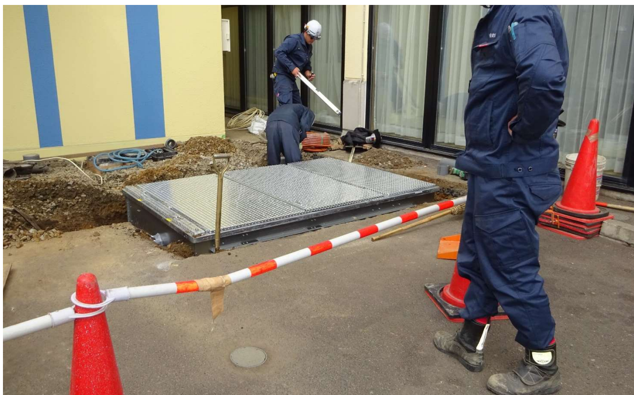
融雪槽の投雪口はかなり大きくスノーダンプで直接投雪できます。
