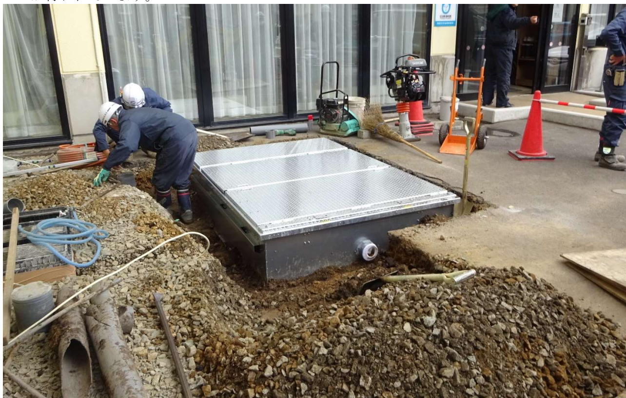
融雪槽を設置しています。
