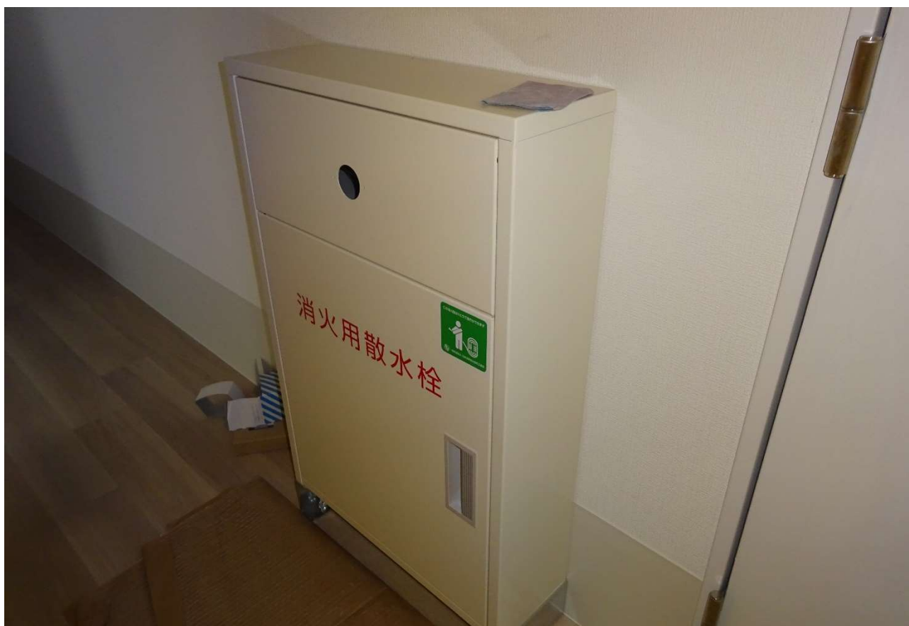
各階に消火用設備が取り付けられています。
