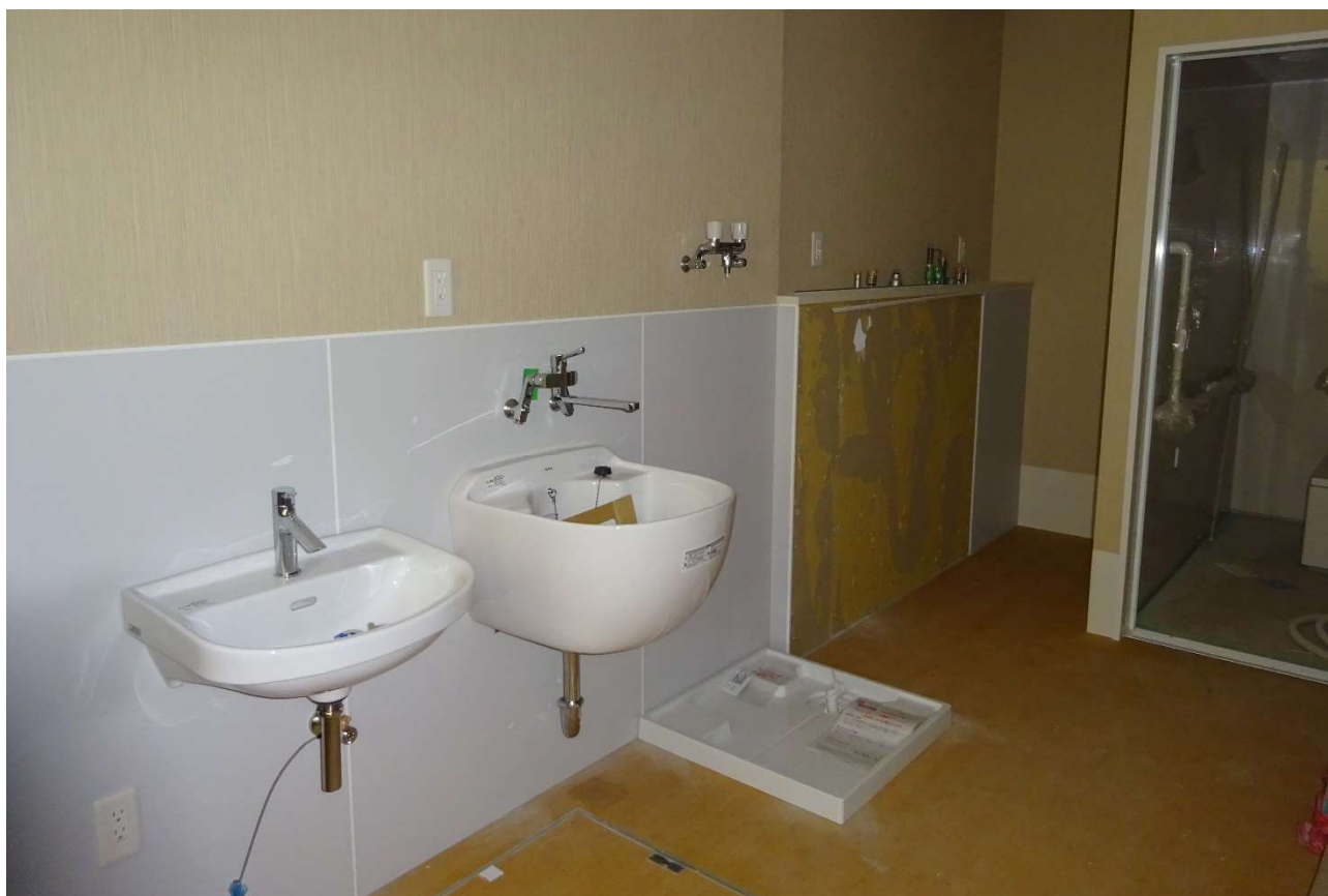
ケアホームゆうあい洗濯室の機器です。
